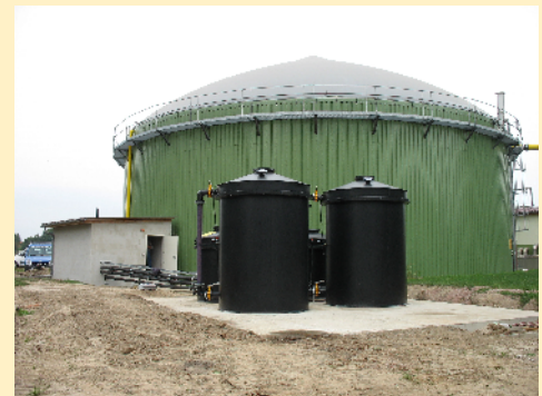
BEKOM-Anlage 170 m 3 /h Rohgas
